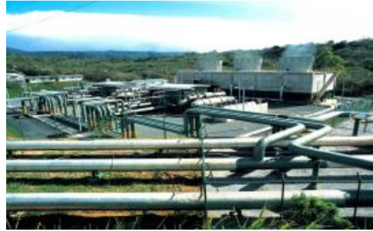
Esta fotografía corresponde a la planta de generación de energía, ubicada en el Proyecto Miravalles.
